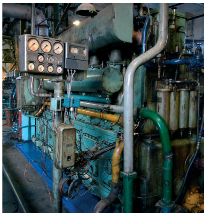
Рисунок 2.24 – машинное отделение дизельной электростанции «ДЭС-16»
